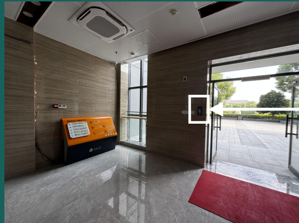
位于博雅楼 A 楼北入口进门右侧
