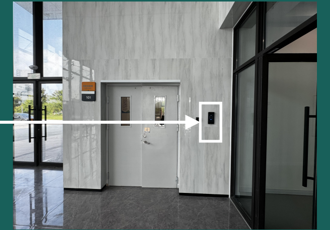
位于微纳平台进门左侧通道口
